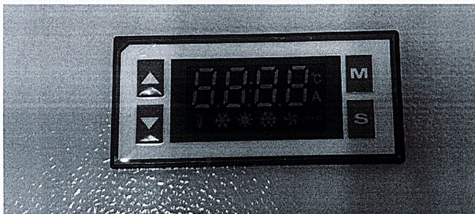
控制面板 (Control panel)
